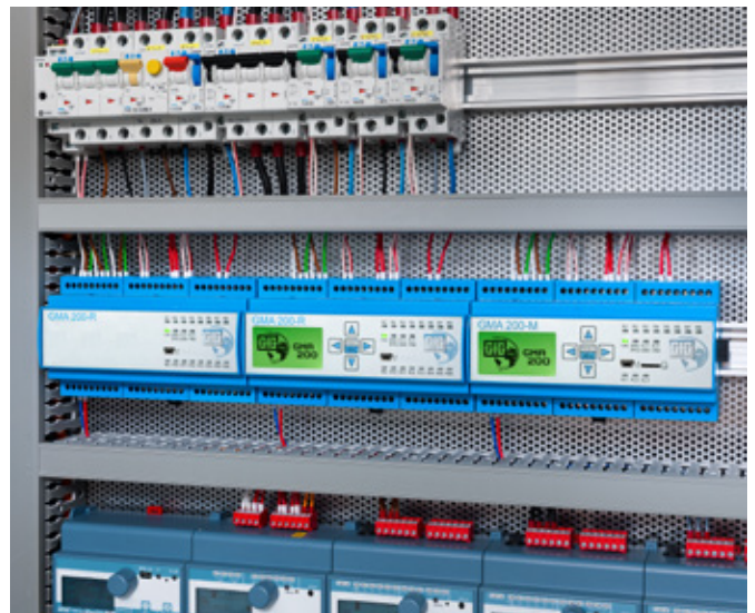
GMA200-MT mit zwei Relaismodulen GMA200-RT und GMA200-RTD im Schaltschrankaufbau.
